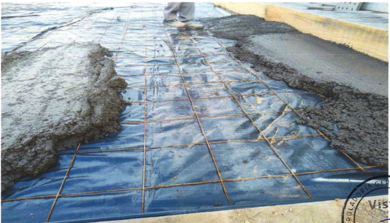
FOTO 14 - FORNECIMENTO E INSTALAÇÃO DE TELA AÇO SOLDADA NERVURADA CA-60, MALHA 15X15CM, FERRO 3.4MM, PAINEL 2X3M, (1,00KG/M 2 ), MALHA POP MÉDIA GERDAU OU SIMILAR
